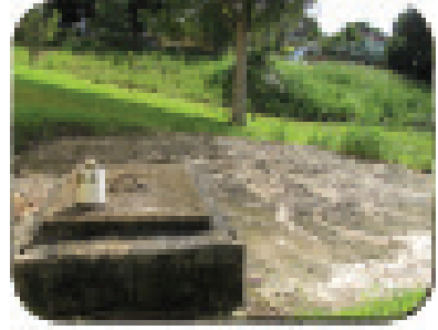
إغلاق خزانات الصرف.
