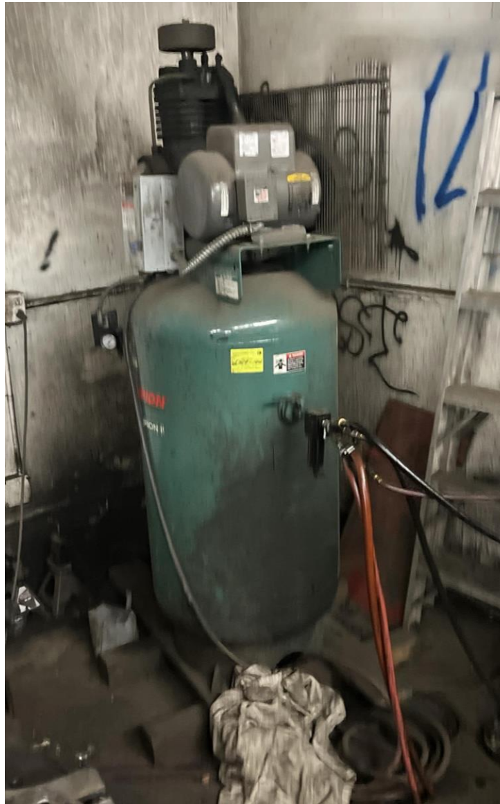
Imagen 5. Compresor de aire.
