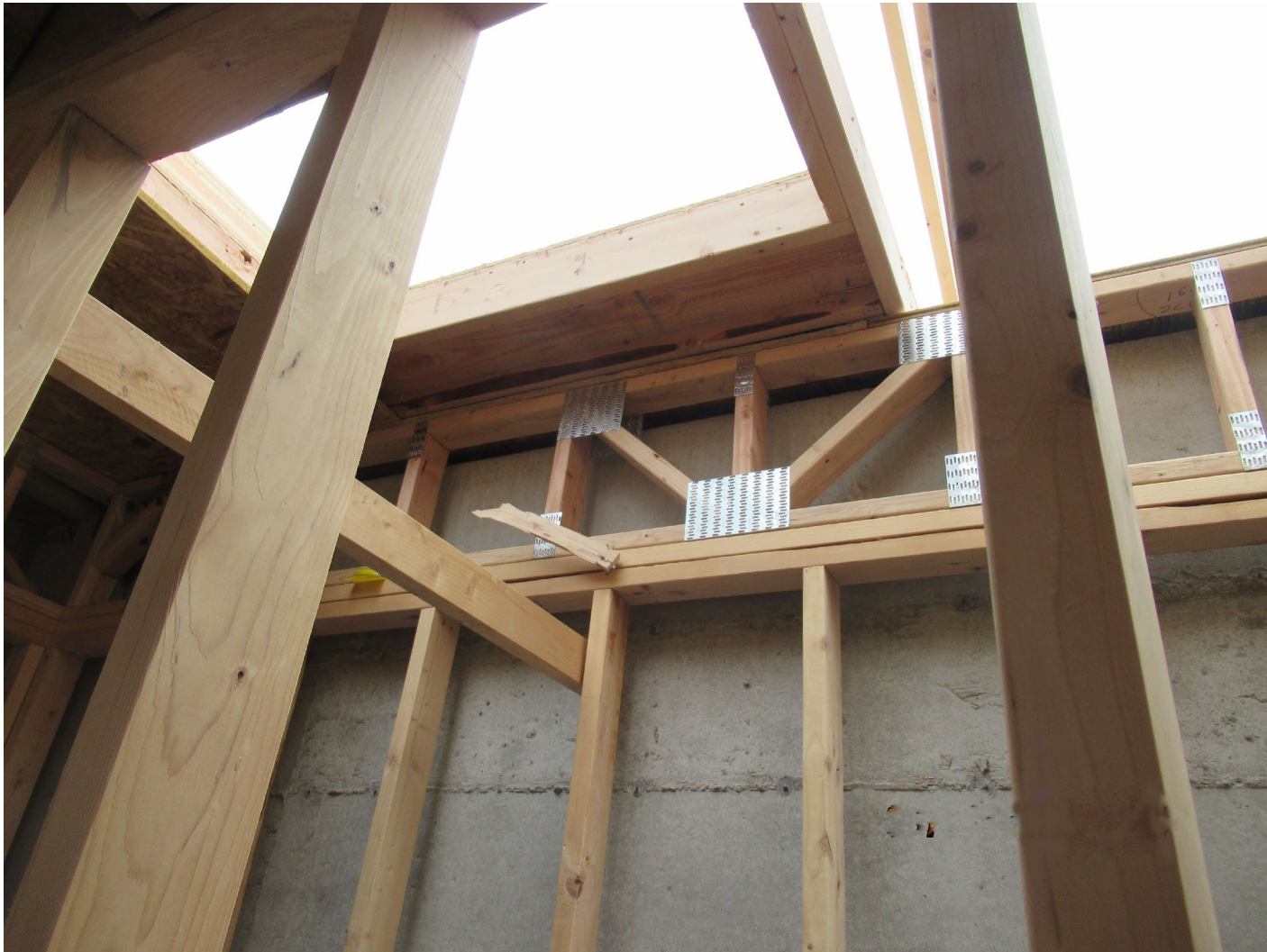
Imagen 8. Vista de la abertura del piso desde el sótano.
