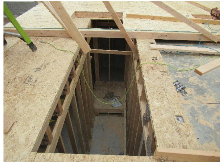
Imagen 1. Abertura de piso sin protección.
