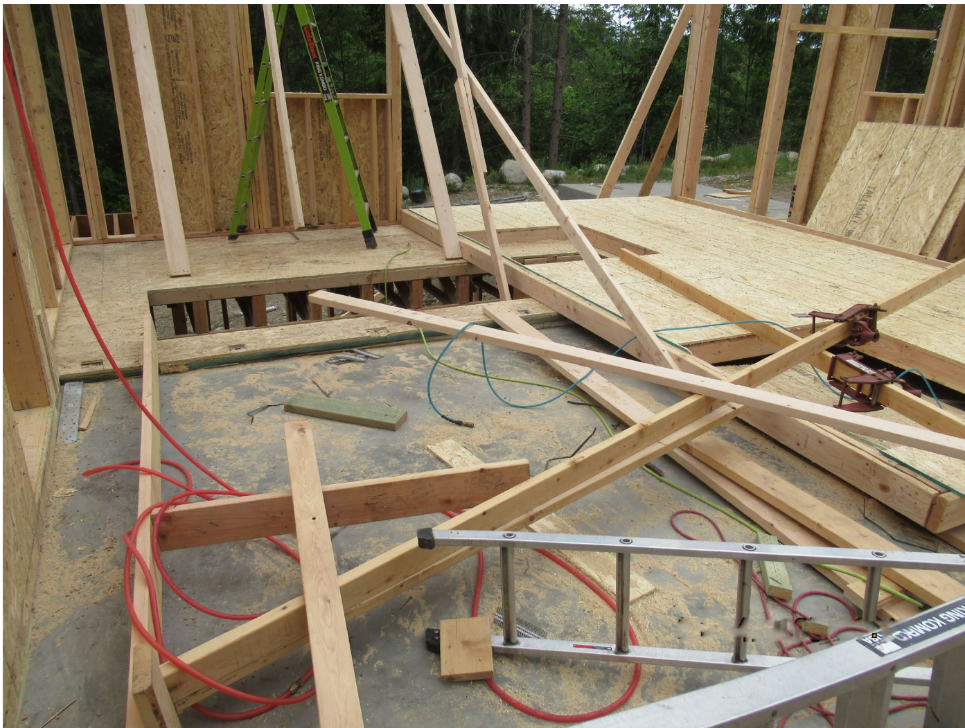
Imagen 7. Soporte de madera roto en el área de trabajo en la que cayó la pared.
