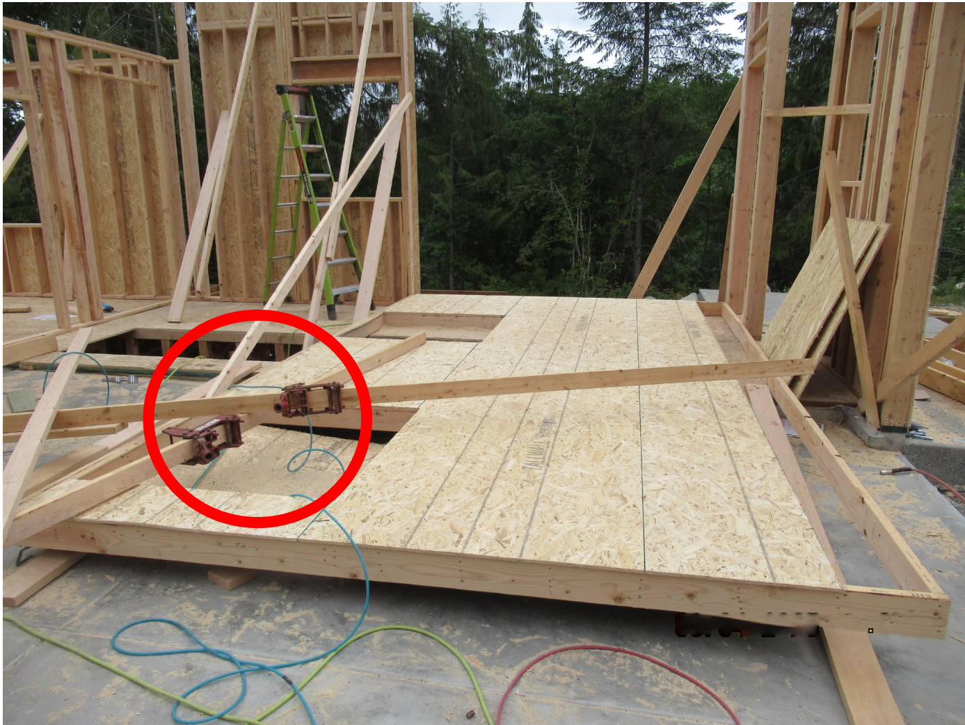
Imagen 3. Pared caída con gatos de pared en los postes.
