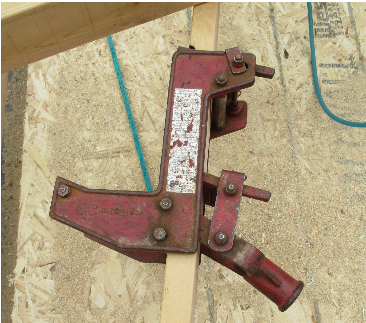
Imagen 4. Gato de pared unido a un poste de madera.
