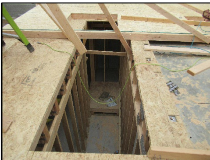
Abertura de piso sin protección.
