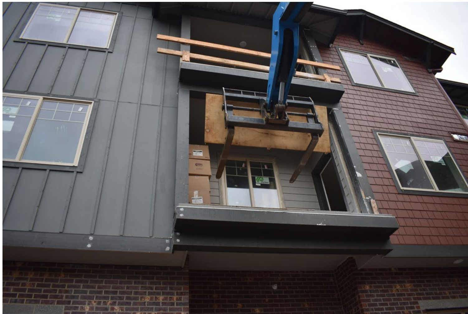
Imagen 3. Acercamiento al balcón desde donde cayó el trabajador.
