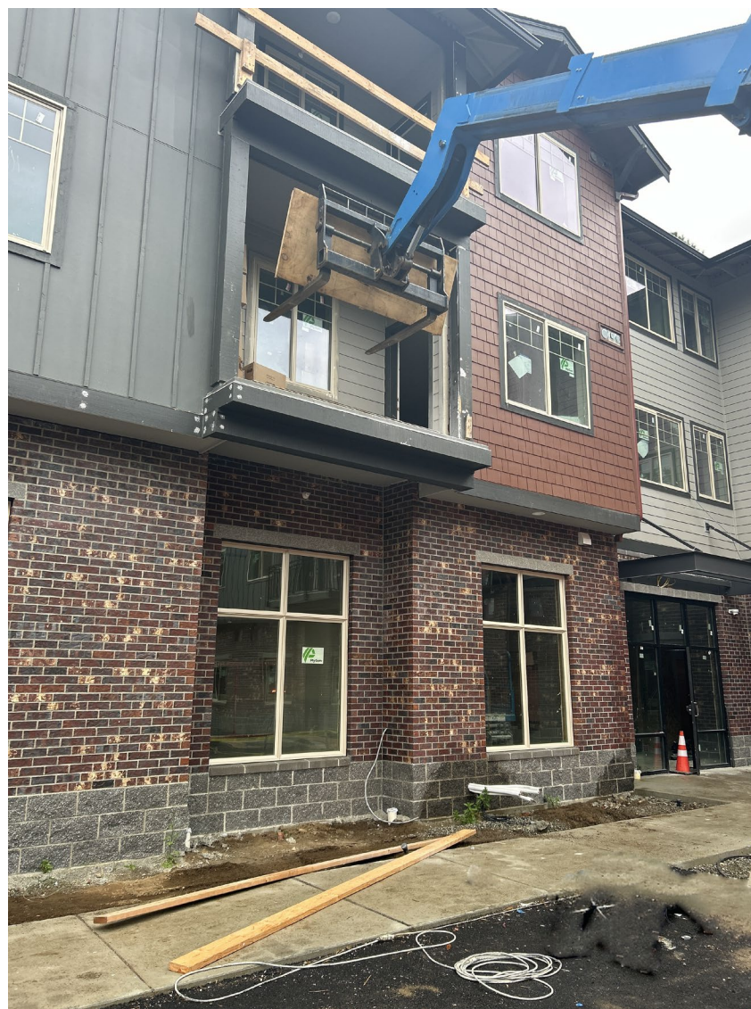
Imagen 2. Balcón del segundo piso desde el que cayó el trabajador, y barandillas rotas en la acera.
