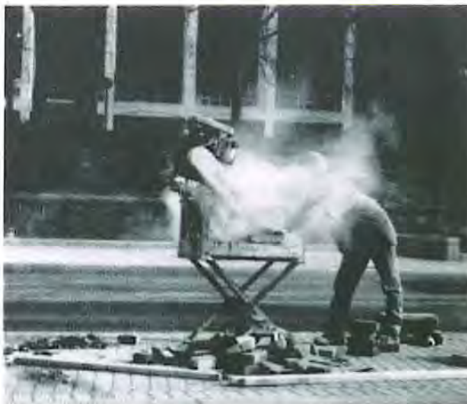
Trabajador de construcción aserrando mamposterías sin control del polvo ni respirador.
