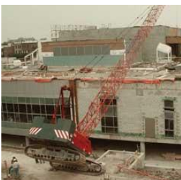
Grúa ladeada en las obras de expansión de una biblioteca. (Foto cortesía de The Blade/Toledo Ohio)
