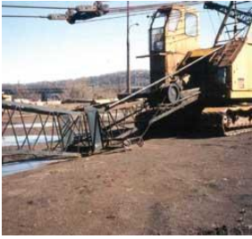
Colapso de la pluma durante el desmontaje de una grúa.
