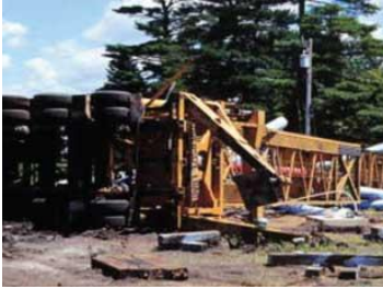
Inclinación de una grúa mientras se intenta izar un tanque de agua.
