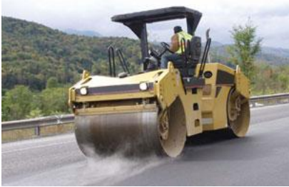
Aplanadora/apisonadora con ROPS y cinturón de seguridad.
