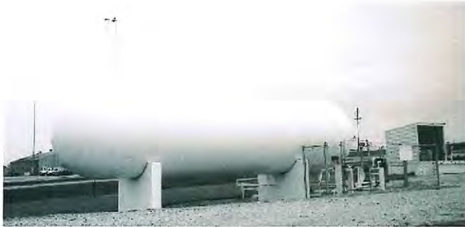
Un tanque de propano de 68,137.41 litros (18,000 gal) con cercado de protección para reducir el riesgo de daño físico al sistema de tuberías exteriores.
