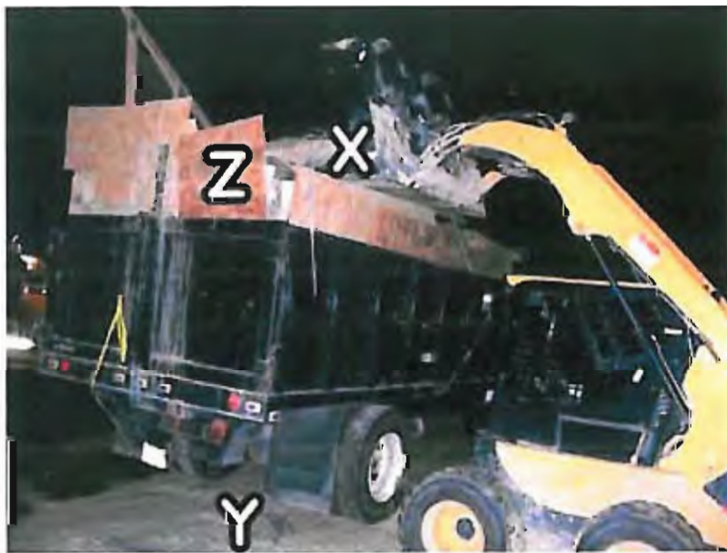
Foto 2. Esta foto muestra el camión de escombros utilizado el día del incidente. Se colocó una X en la foto para indicar la ubicación aproximada de la víctima antes de la caída, una Y para indicar la posición aproximada de la víctima
