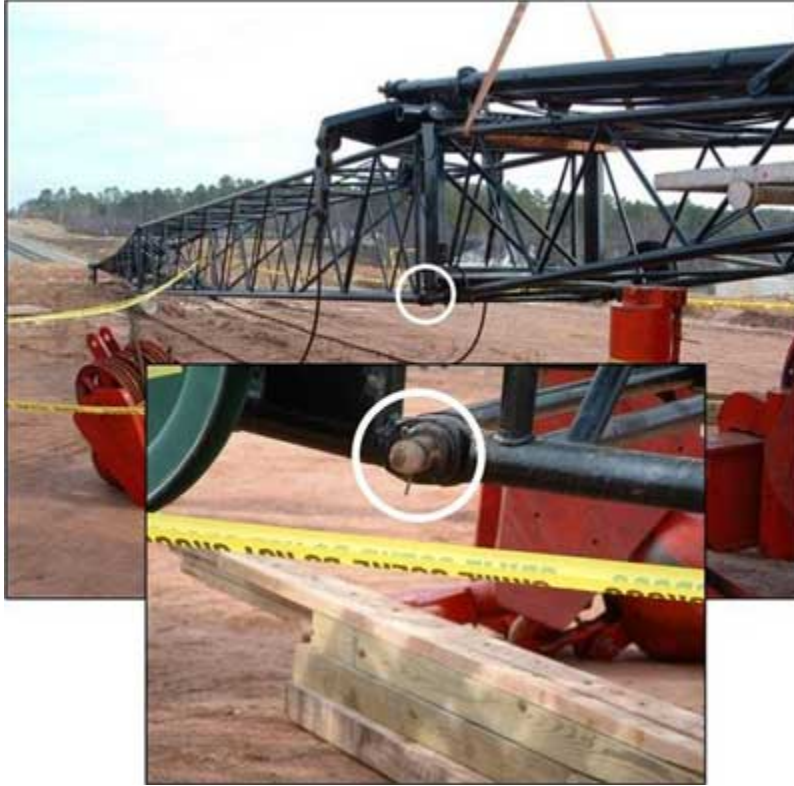
Foto 3. Esta fotografía muestra un primer plano del lugar en el que la víctima fue golpeada por la pluma. Las maderas de 4x4 pulgadas que se ven en la fotografía fueron llevadas al lugar y se usaron para hacer palanca contra la pluma mientras la segunda grúa la levantaba. El bulón está encerrado en un círculo y fue uno de los dos bulones inferiores que se sacaron. Los dos bulones inferiores se volvieron a colocar durante las operaciones de rescate. El recuadro muestra una ampliación del bulón. (Foto cortesía de NIOSH).
