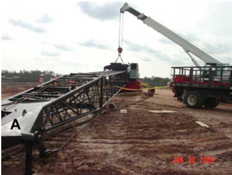
Foto 2. Esta fotografía muestra la punta de la pluma de celosía (A) después de que la pusieran en el suelo ( foto cortesía de NIOSH )
