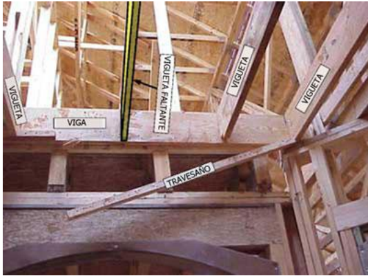
Foto 2. Esta foto ilustra donde el travesaño se separó de la viga a la que estaba clavado y el lugar por donde se cayó el trabajador. Note la vigueta faltante. (Foto cortesía de NCDOL/OSH).
