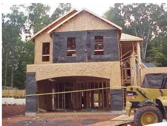
Foto 1. Esta fotografía ilustra la vivienda de dos pisos donde los obreros armaban la estructura cuando sucedió el incidente
